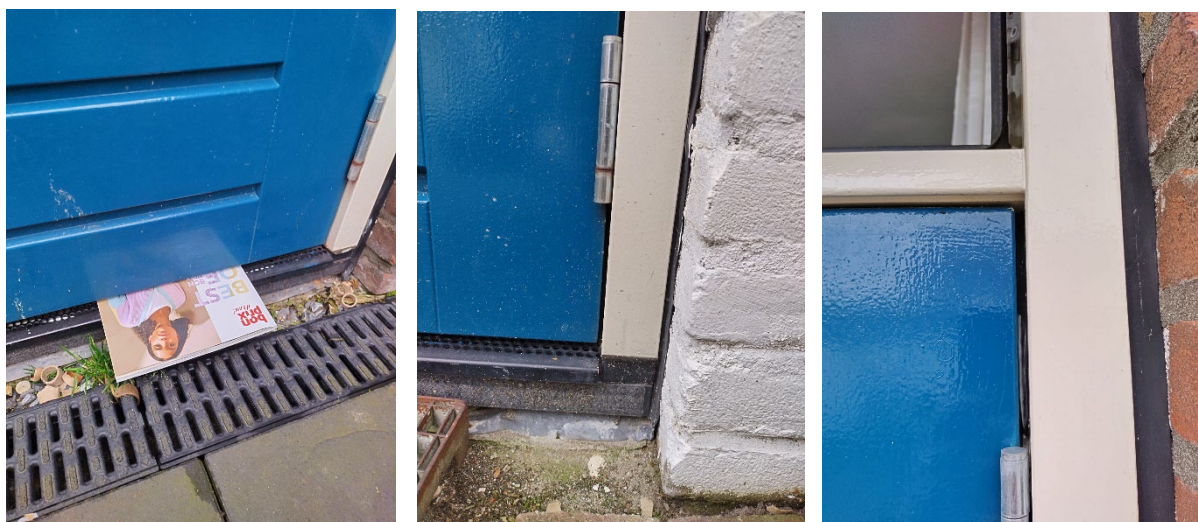
Afbeelding 9, 10 en 11: Er past gemakkelijk een tijdschrift of reclamefolder tussen de drempel en de achterdeur, waardoor de tochtdeur onvoldoende goed functioneert, daarnaast zijn de deuren scheef afgehangen.
