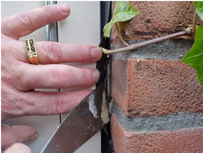
Afbeelding 4: Het ontbreken van compriband.
