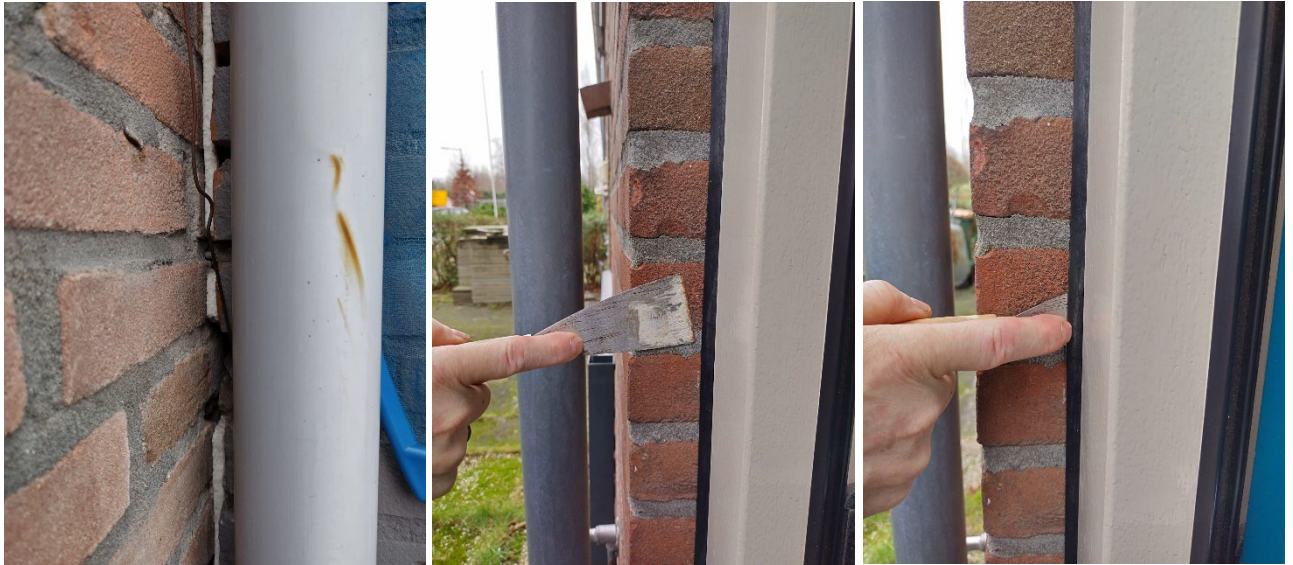
Afbeeldingen 1, 2 en 3: Duidelijk beeld waarbij de afdichting onvoldoende is, waardoor buitenlucht eenvoudig de woning kan binnenkomen.
