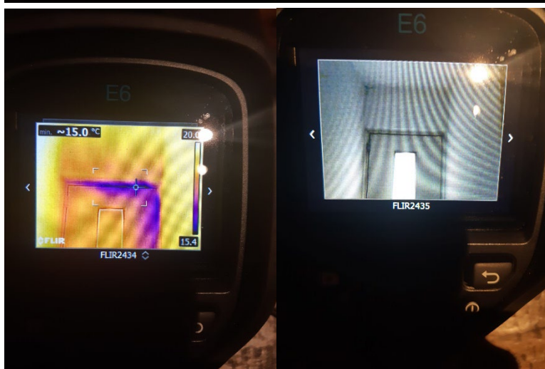
Afbeelding 5, 6, 7 en 8: Warmtebeelden van raam- en deurkozijnen, waarbij duidelijk te zien is dat de koudste onderdelen langs de randen van de kozijnen komen.
