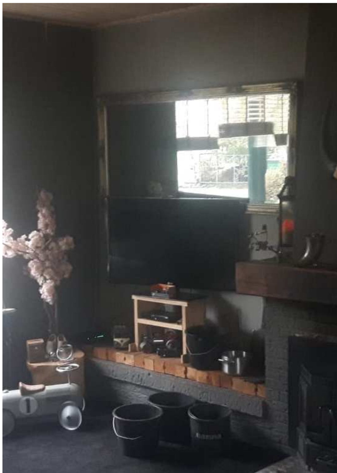
Foto 1 – Emmers onder het lekkende dak
